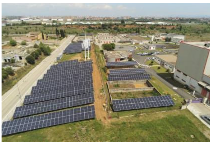
Placas fotovoltaicas en la depuradora de Sabadell-Riu Sec | Foto: ACA
